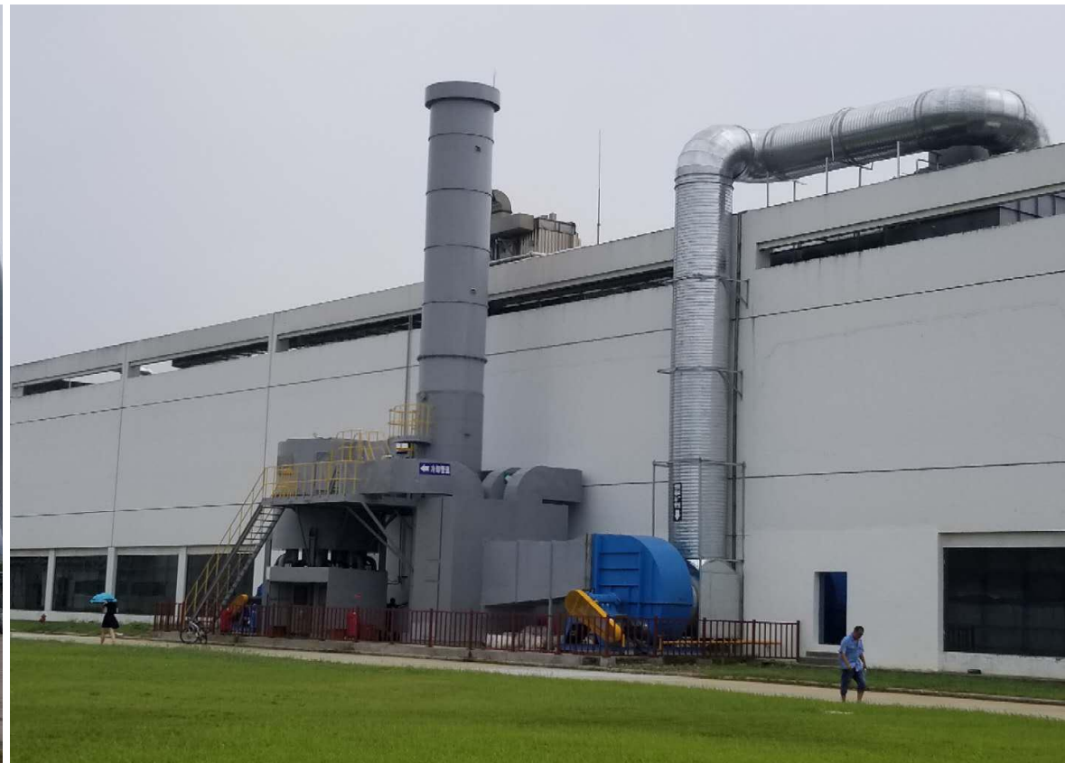
企业：四川中金医药包装有限公司 风量：RC80,000Nm 3 /h + RTO 54,000Nm 3 /h
