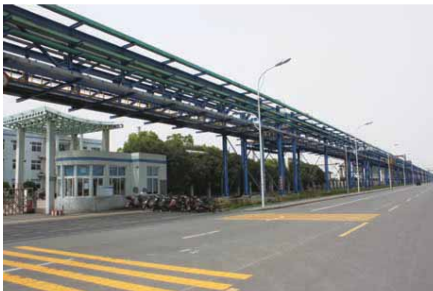
园区内的管廊，所有的液体和气体都通过管廊输送
