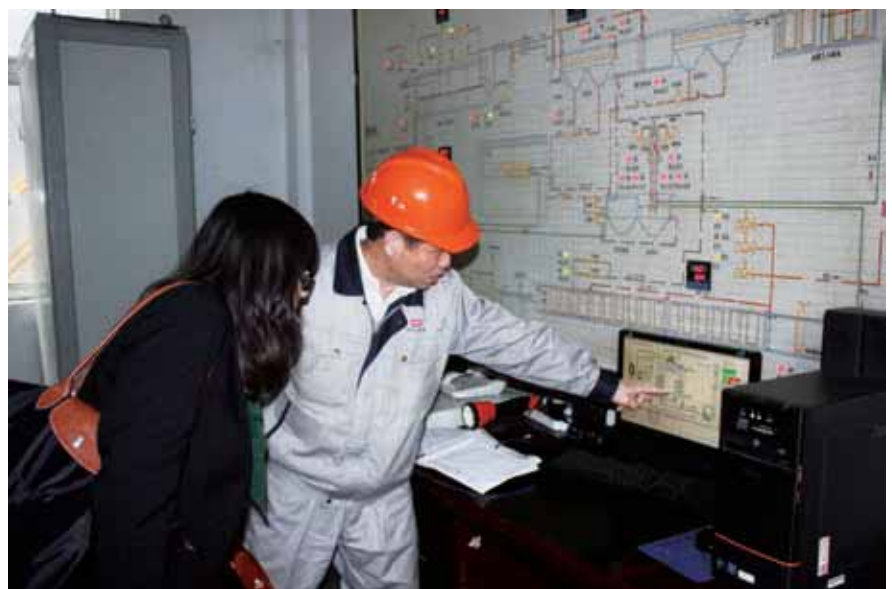
争光树脂污水处理项目的自动化控制室
