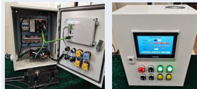
控制终端实物
