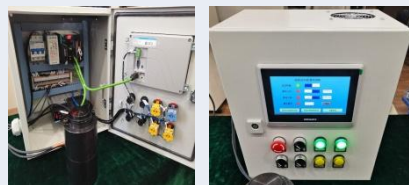
控制终端实物
