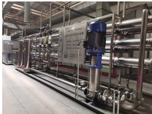
图3 涂装车间EDRO设备现场图
