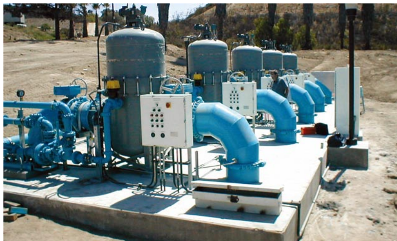
5 - 24 伊顿型号2596 滤器，拥有逆流洗涤辅助抽水泵。此装置是安装在一个废水处理场地上。
